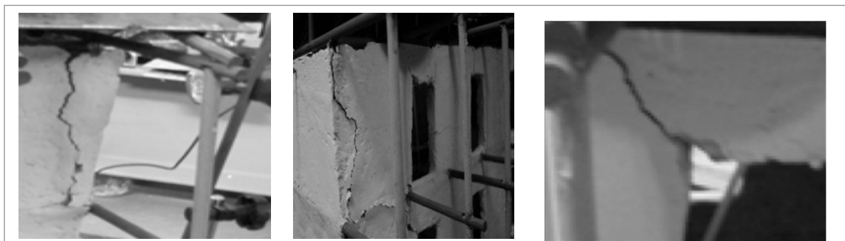
Figura 30. Agrietamiento producidos en la zona frontal por el evento sísmico
