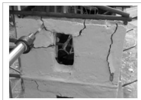
Figura 28. Agrietamiento en la zona lateral derecha luego del evento sísmico
