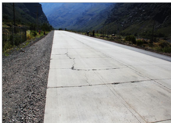
Figura 8. Grietas en un pavimento diseñado por AASHTO 1993 con losas 4 m de largo Figure 8. Cracking on a pavement designed by AASHTO with slabs of 4 m length
