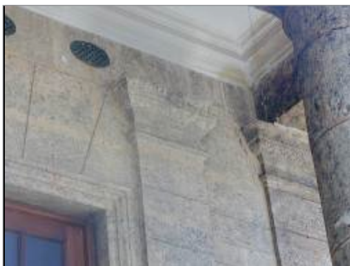
Figura 15. Manchas de humedad por filtraciones en la cubierta
