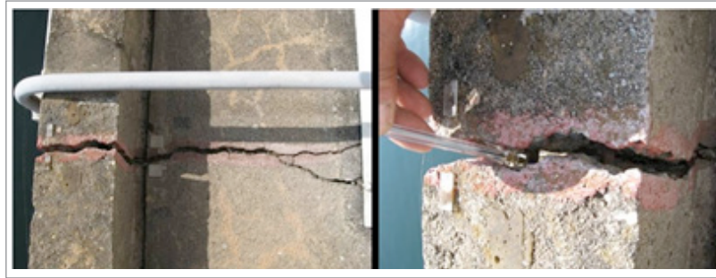
Figura 3. Grietas con el refuerzo expuesto Figure 3. Cracks with exposed reinforcement
